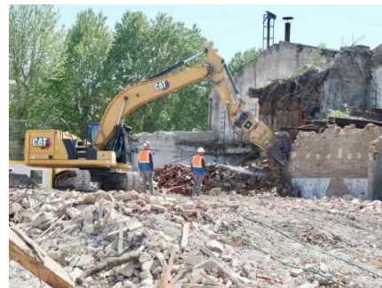
A Montelupo via alla demolizione del complesso ex Fanciullacci: il recupero con fondi Pnrr
